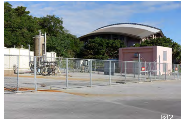
図2. 沖縄県南城市の温泉メタンガス発電施設
