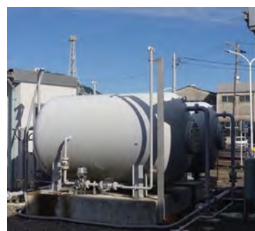
ガス貯蔵タンク
