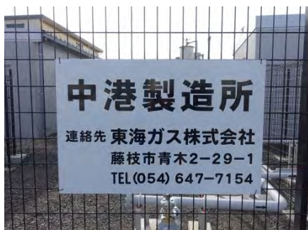
温泉メタン都市ガス化施設
