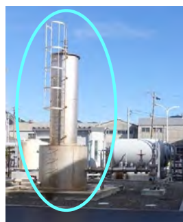
メタン分離槽
