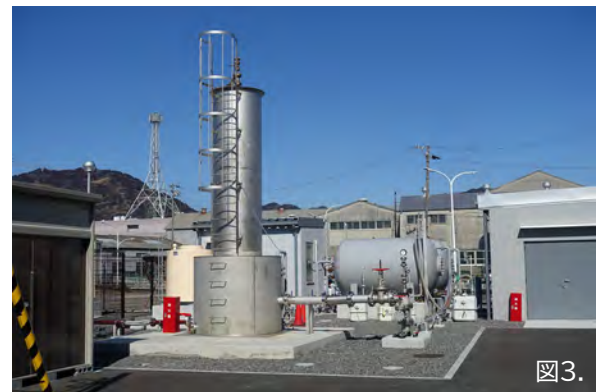
図3. 静岡県焼津市の温泉メタン都市ガス化施設
